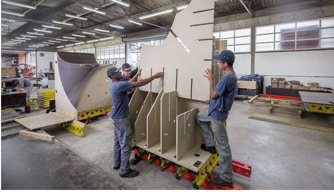
Figura 1: Unidades de encofrado 3D producidas mediante CNC a partir de 60.000 m 2 de aglomerado para el Museo del Mañana, diseñado por Santiago Calatrava. Instalación CNC de trabajo en madera, PERI Brasil (PERI, 2017a).
